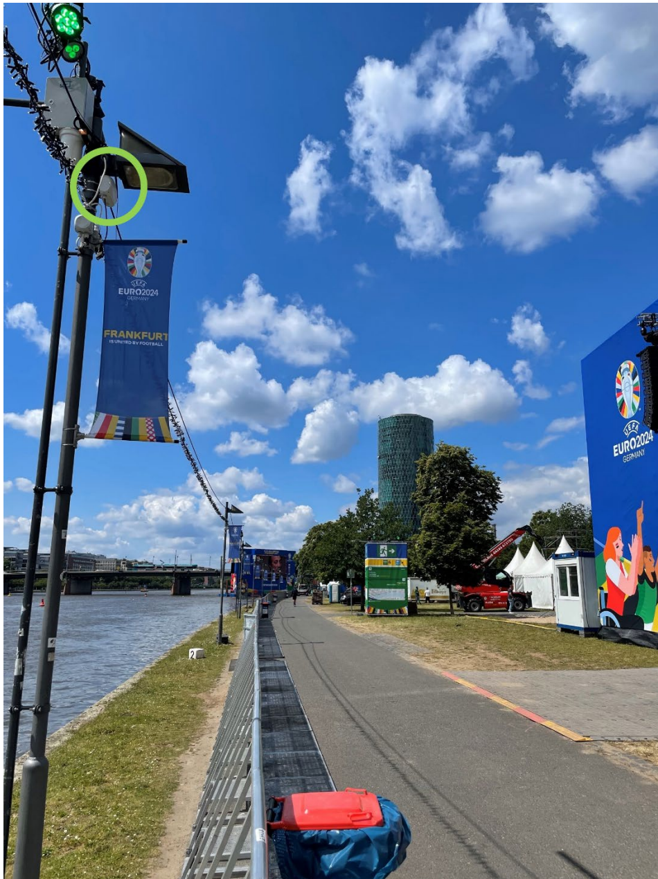
Installierter RF-Tracker auf der UEFA Fan-Zone
