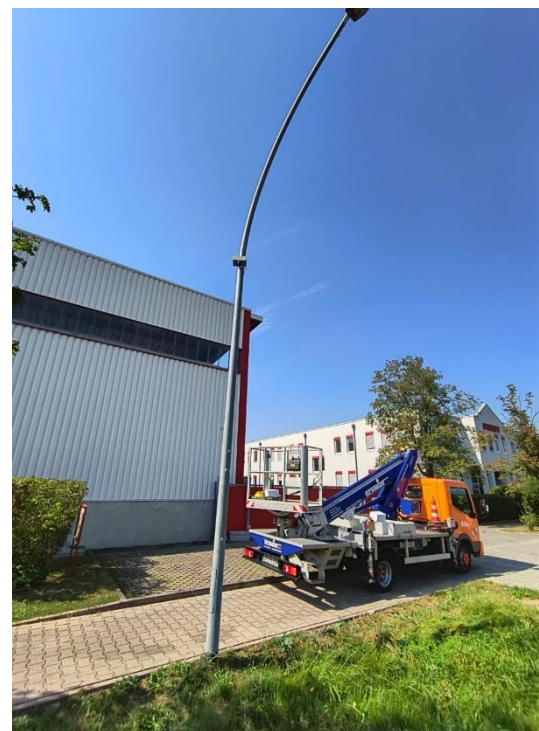
Parkraumkamera an Lichtmast
