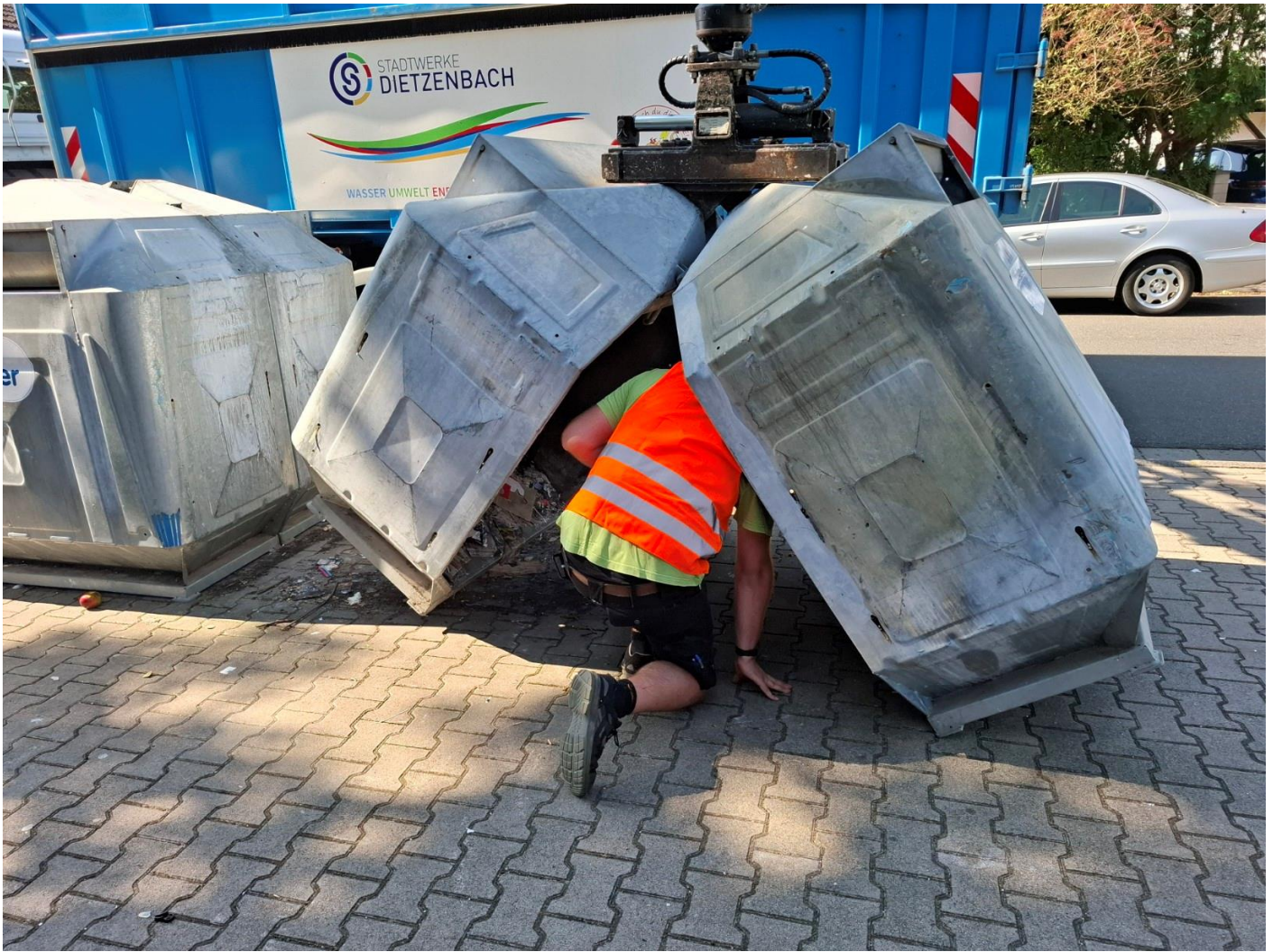
Einbau Füllstandssensor in Altpapiercontainer
