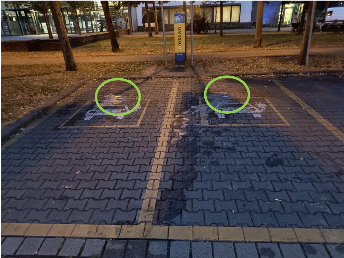
Eingebaute Parkraumsensoren (Bodensensoren) vor einer E-Ladesäule
